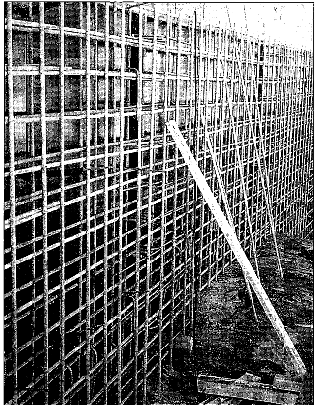
Tillbyggnad av Hasselbladslaboratoriet, Sahlgrenska sjukhuset i Göteborg. Totalt användes cirka 30 000 meter Fiberbar kompositarmering fördelat på dimensionerna 10, 12 och 15 mm.
